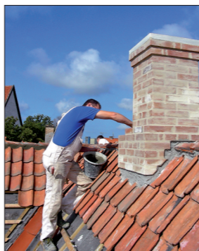
Muret inddækning under skorstenssokkel
