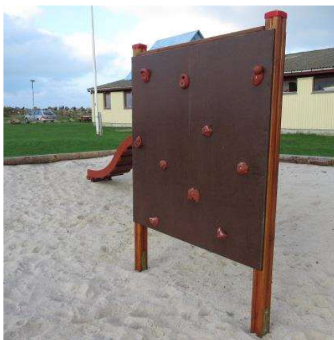
2013 – Klatrevæg Skal renoveres
