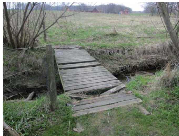
Bro over å skal repareres. Afskærmningshegn mod åen mangler.
