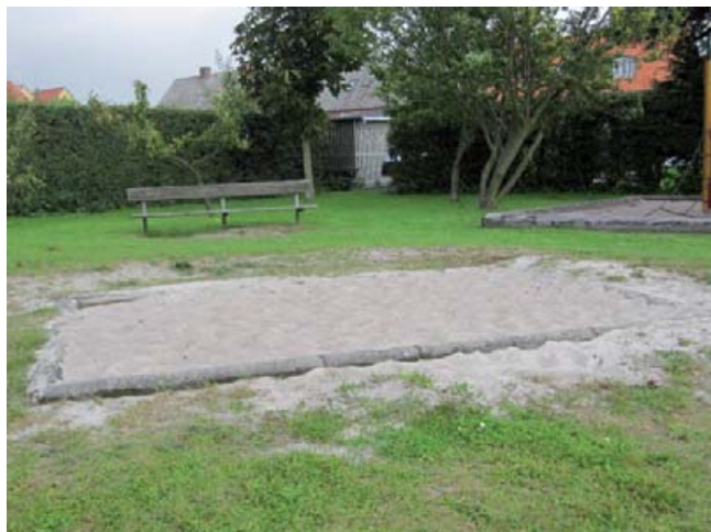
Ældre nedgravet sandkasse med betonafrænsning
