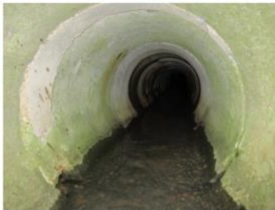
Set fra syd mod nord. Forskudte elementer samt revner
