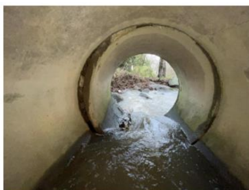
Bærende overbygning: Forskudt rørsamling 1. element fra N-facade medfører borterodering fyld
