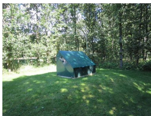
Råvandsstation i skov
