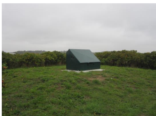
Råvandsstation i mark
