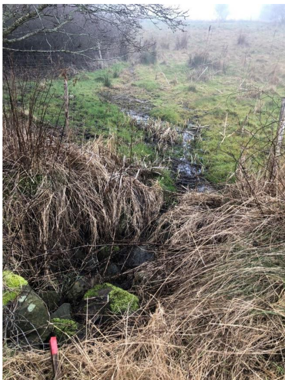
Figur 1: Billede er taget i kanten af vejen, hvor vådområdet ses øverst i billedet, og vejunderføringen ses nederst til venstre i billedet. Stenen som ligger foran vejunderføringen, er den tidligere stensætning, som nu er faldet sammen.
