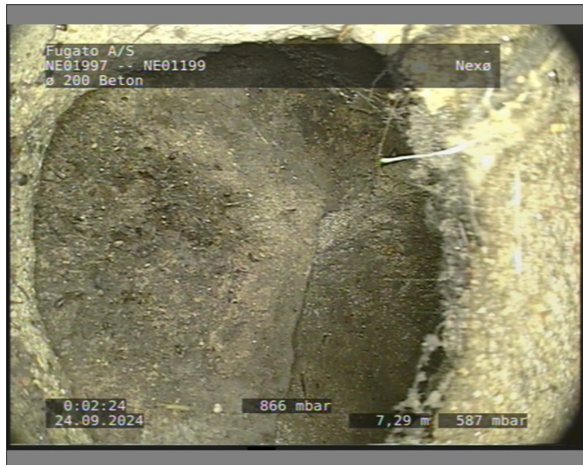
Foto: 1_6A 7,29m, Påhugget stik klasse 1, urref 2, Manglende forbindelse mellem stik/hovedledning
