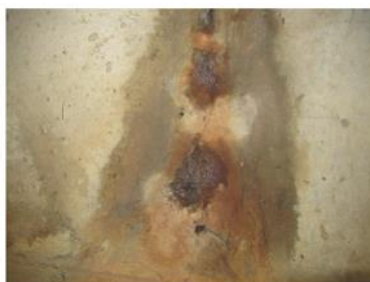
Rustudfældninger i samling mellem rør
