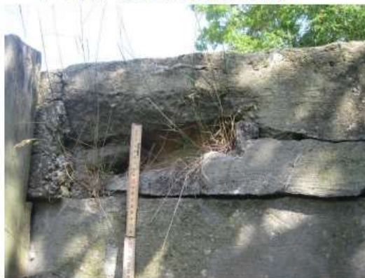
6. Kantbjælke: Sydlig kantbjælke med kraftig forvitring
