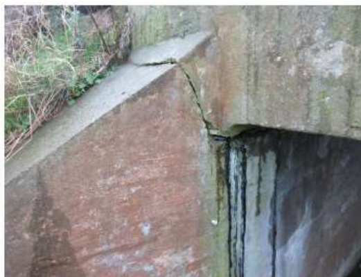
4. Fløje: Grove revner i NØ-fløj
