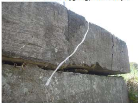
5. Kantbjælke: Nordlig kantbjælke mangler fastgørelse til bærende konstruktion (gælder også i syd)
