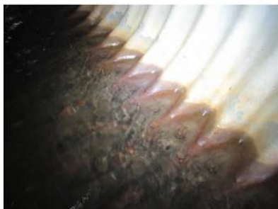
Korrosion ved vandspeil op til boltesamlinger.
