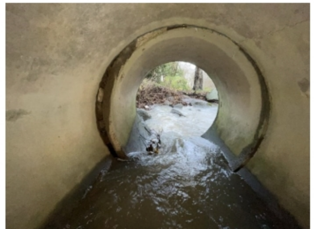
Bærende overbygning: Forskudt rørsamling 1. element fra N-facade medfører bortrodering fyld
