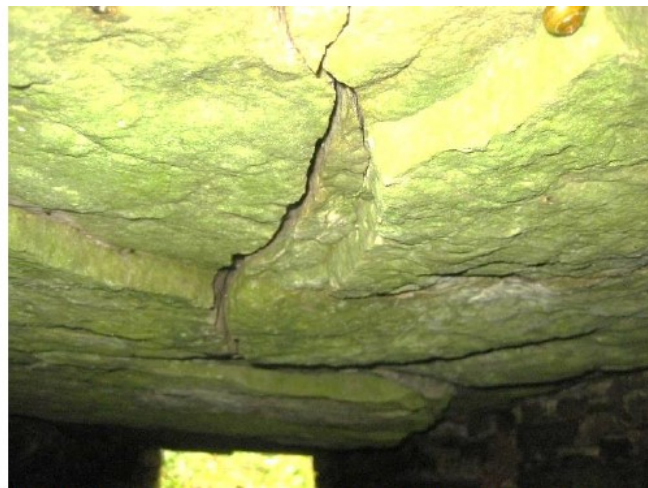
Underside brodæk, brud i bærende stenkiste-overligger
