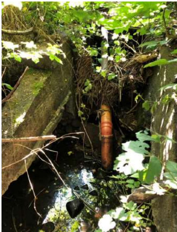
Figur 3: Fotografi af opstemningsanlægget ved Åremyr. Billedet er taget ved besigtigelsen 11. august 2020. Det orange rør er en ålepassage. Det fremgår af billedet, at siderne i opstemningsanlægget er ved at falde sammen.
