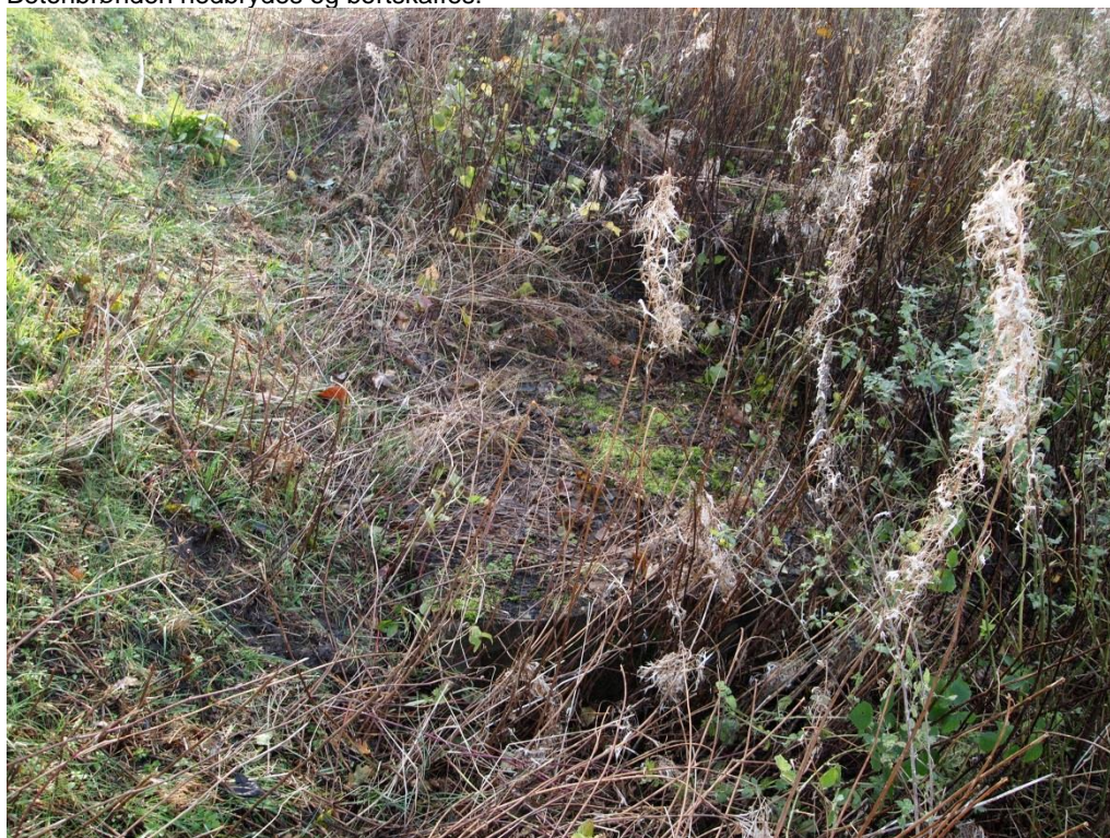
Figur 5.5: Betonbrønd langs Bolsterbjergvej.
