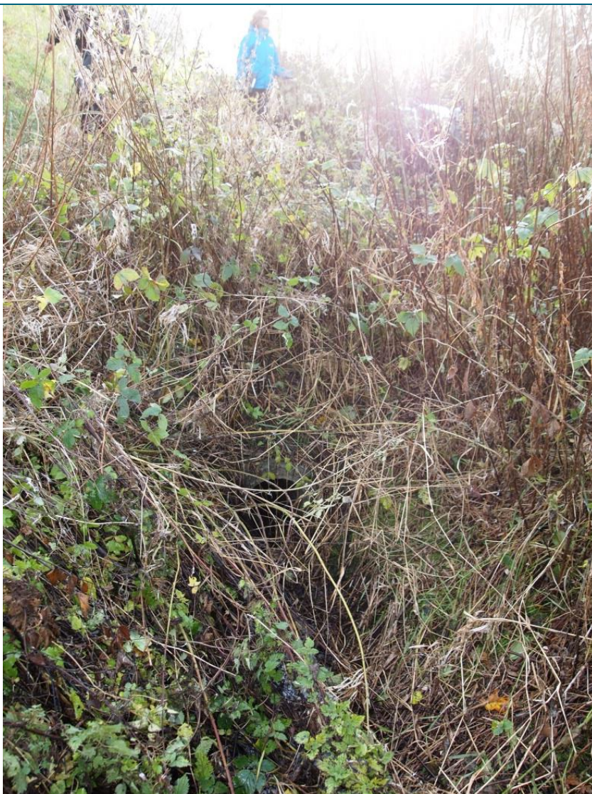
Figur 3.2 Indløb til brønd fra vejgrøft.
